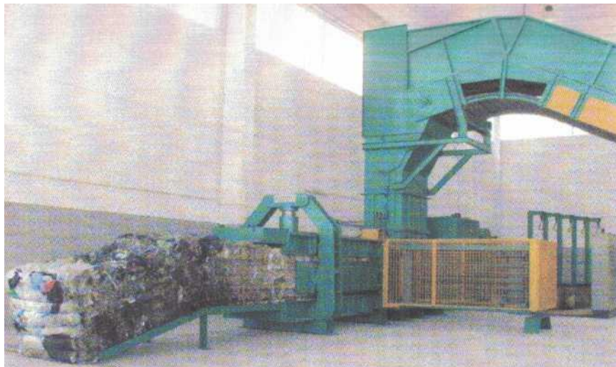
Рисунок 17.6.1. Прессовальная установка на станции сбора и обработки вторсырья
